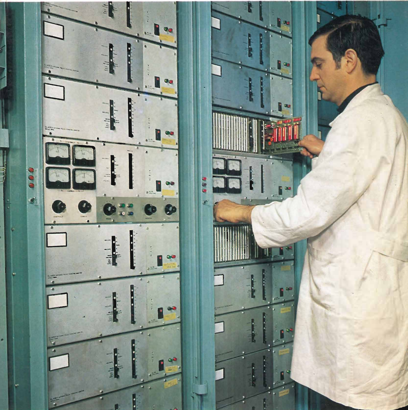
Apparati Eladex della Italcable per l'automazione del servizio telex intercontinentale (v. pag. 78).
